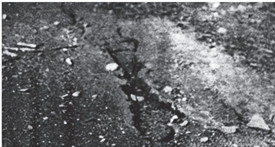
СЛ. 10. ПУКОТИНЕ ИЗ КОЈИХ ЈЕ ИЗБИЈАЛА ТОПЛА ВОДА СА МУЉЕМ КМ 594+825 У ОКОЛИНИ Ж. С. МИЛЕТКОВО
