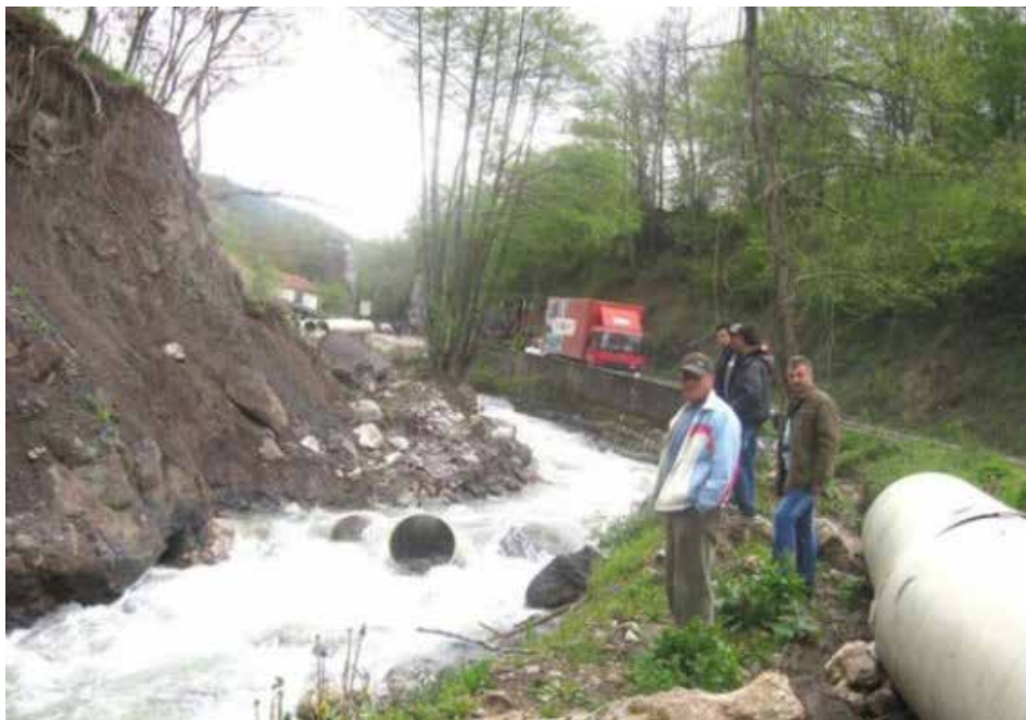
Слика 6. Покренуто клизиште при постављању цевовода на Бистрици код Нове Вароши
