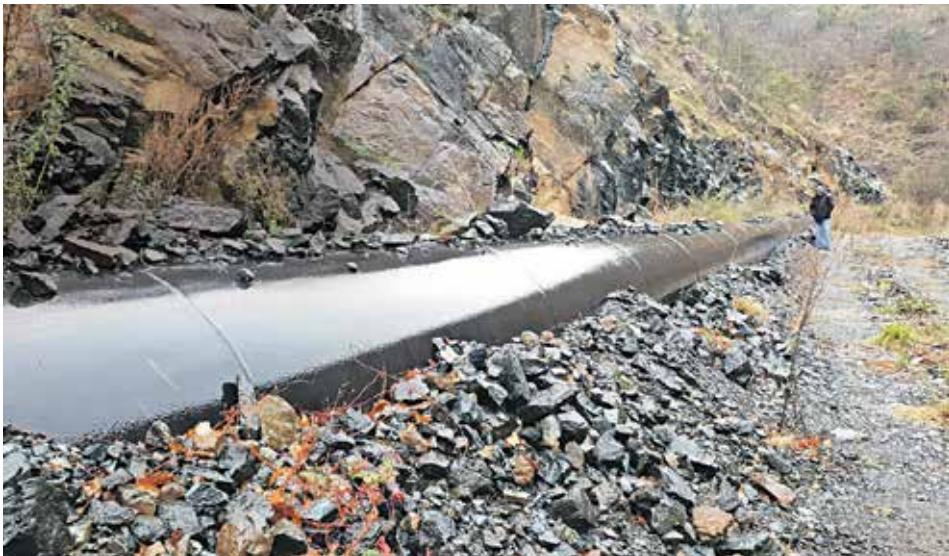
Слика 4. Уништена Брезанска река цевоводом дужине 3,6 km
