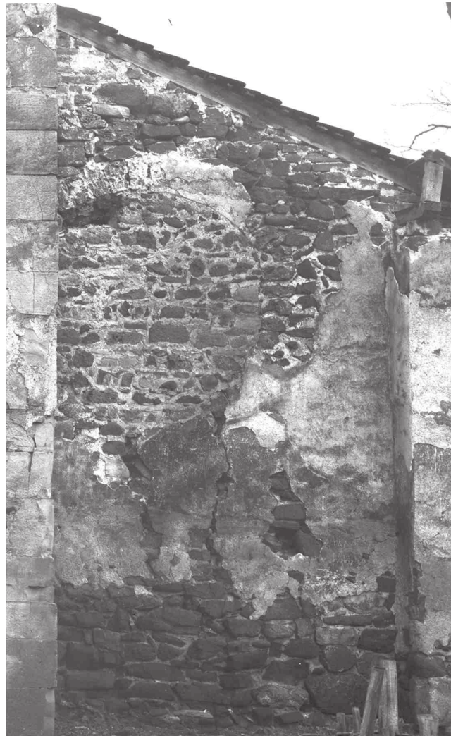
Сл. 4. Остаци малтерних слојева на јужном делу западне фасаде припрате, детаљ сл. 1
