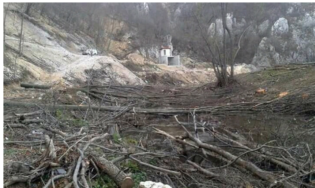
Слика 3. Резервисан простор у кањону Млаве за регионално извориште Млавско-моравског регионалног система пре и након незаконитог уступања тог простора приватном инвеститору за изградњу МХЕ
