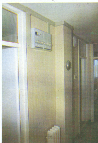
Električna instalacija — IKL lajsne
